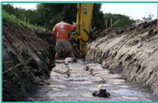
Auslauf eines RÜB: Grabengefälle beträgt unter 1 Prozent
